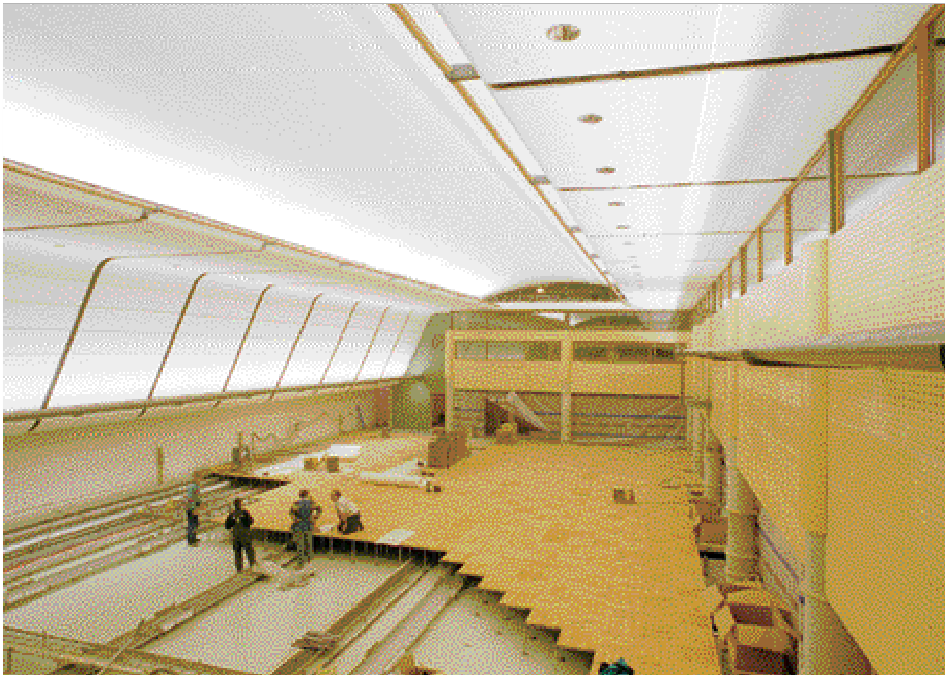
Installationsgolvet i Räddningscentralen är inlagt av Tretum och belagt med parkett i oljad kärnbok.
